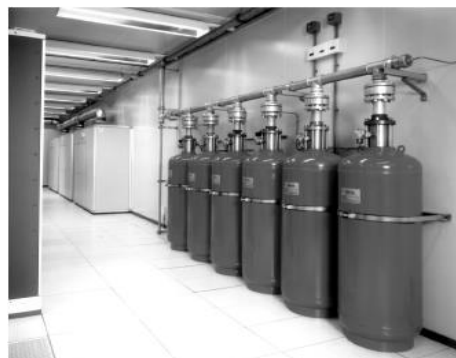
Chemische blusgassen t.b.v. computerruimte
