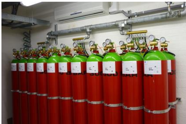
Een inerte blusgasinstallatie
